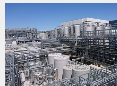
■ 排水処理設備
