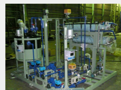
■凝集沈殿設備
