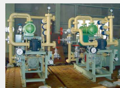
■潤滑油配管ユニット
