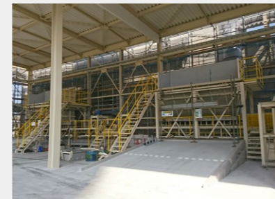
■ リサイクル燃料設備
