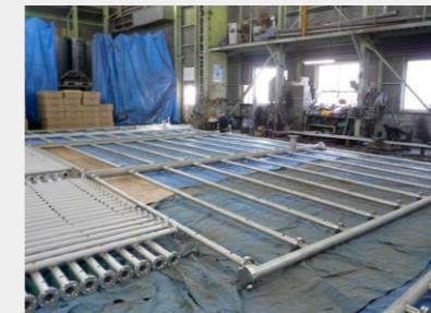
■ 散気装置配管
